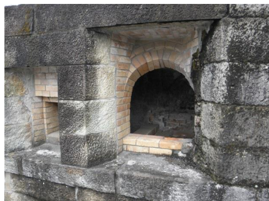
《萑山反射炉》 炉入口。 周りは伊豆石。炉は耐火煉瓦で作られている。
